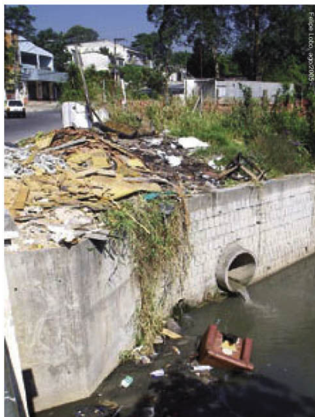
Despejo de esgoto e depósito de lixo no Córrego Tanquinho, um dos afluentes da margem direita da represa na Subprefeitura da Capela do Socorro, município de São Paulo
